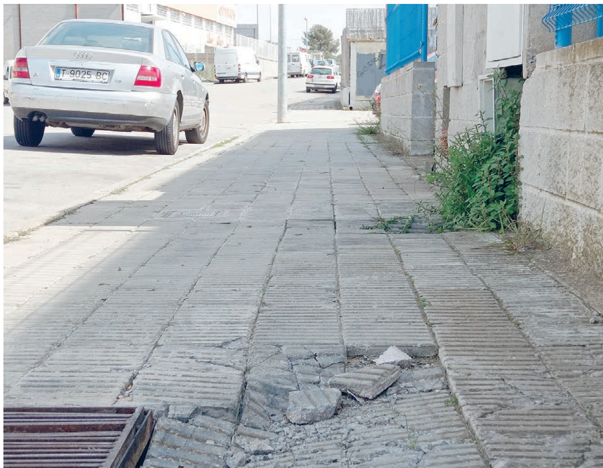
Les voreres del polígon estan en mal estat en alguns trams. / TDB
